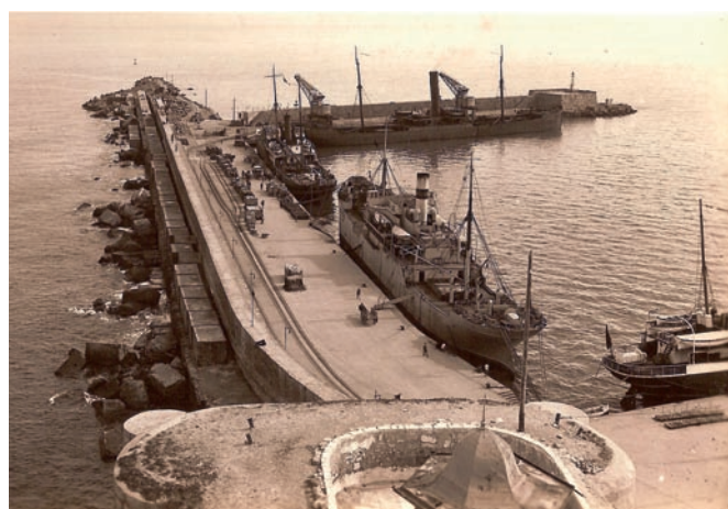
Inicio de las obras de prolongación del Dique Nordeste. Foto Archivo Juan Díez. 1922.
